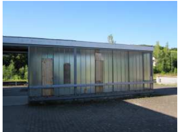
Zerstörte Scheiben sind notdürftig durch Holzplatten ersetzt worden
