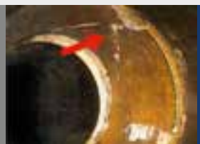
Riss im Anschluss
