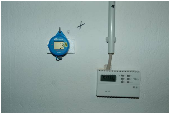
Abb. 4: Datenlogger und Heizungssteuerung im zentralen Außenmagazin des Bergbau-Archivs
