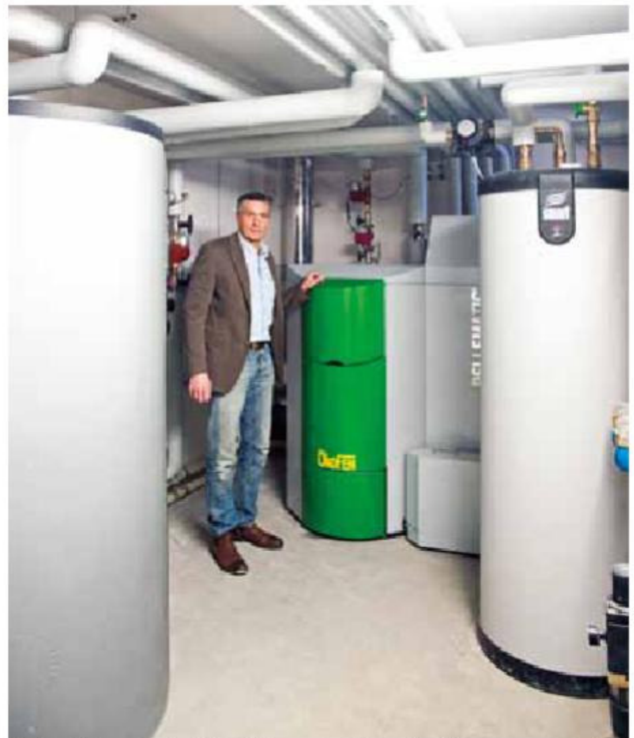
Markus Klein neben der Pelletsheizung, die 9 Einfamilienhäuser versorgt. In den vorderen runden Behältern wird Warmwasser gespeichert.
