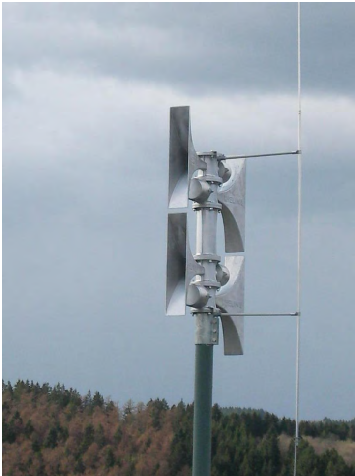
Ansicht einer neuen elektronischen Sirene Standort: Rathaus
