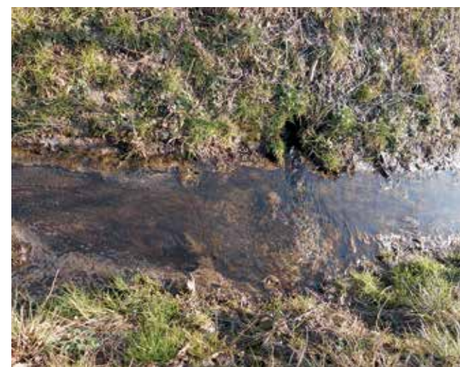
Drainage-Ausschwemmungen in Gräben (hier: Legden-Asbeck, Nähe Haus Asbeck)
