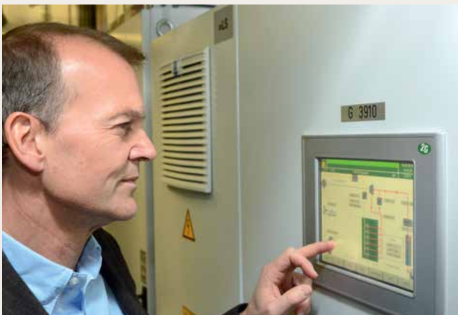
Vor dem elektronischen Eingabedisplay des Blockheizkraftwerks: Geschäftsführer Detlev Beune tippt aktuelle Parameter ein.
