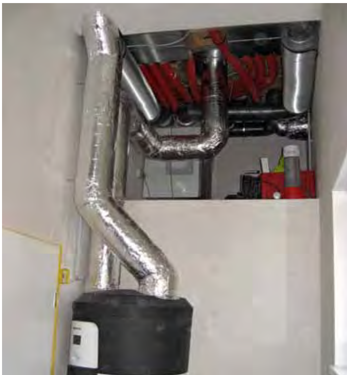
Die gut überschaubare Haustechnik für Lüftung (oberhalb der Gästetoilette) und die Warmwasserwärmepumpe.
