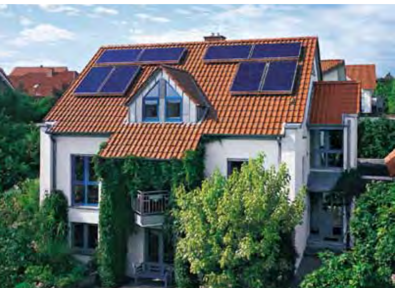
Mit einer fachgerecht installierten Solaranlage wird viel Heizenergie eingespart. Foto: Schüco International KG.
