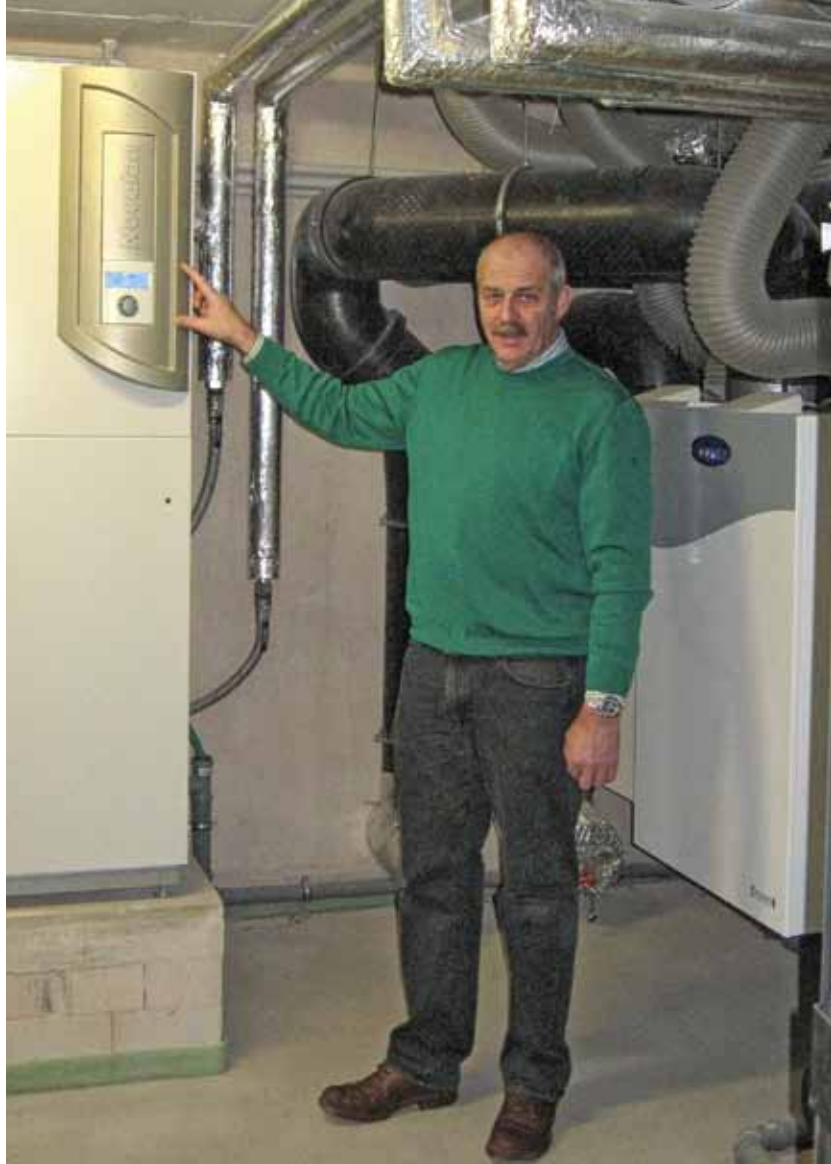
Klaus Ventker im Technikraum präsentiert das Herzstück der Haustechnik, die Novelan Wärmepumpe.
