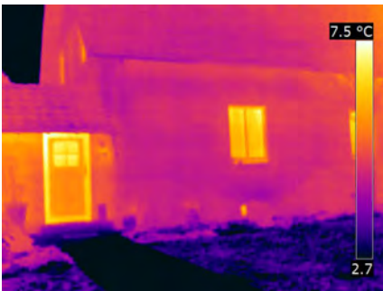
Hohe Oberflächentemperaturen an Anbauten
