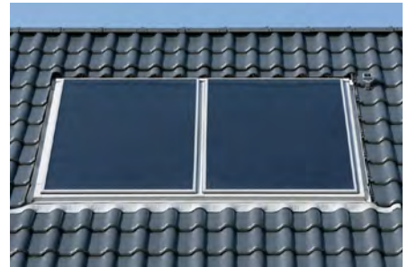
Thermische Solaranlage, Indachmontage, Quelle: Schüco
