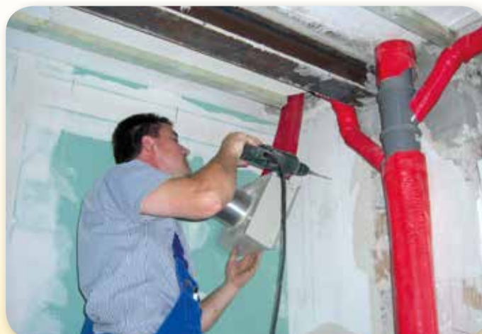
Im kompletten Haus hat Familie Szturmaj eine Lüftungsanlage mit Wärmerückgewinnung installiert. Die Fenster zur stark befahrenen Straße können geschlossen bleiben.
