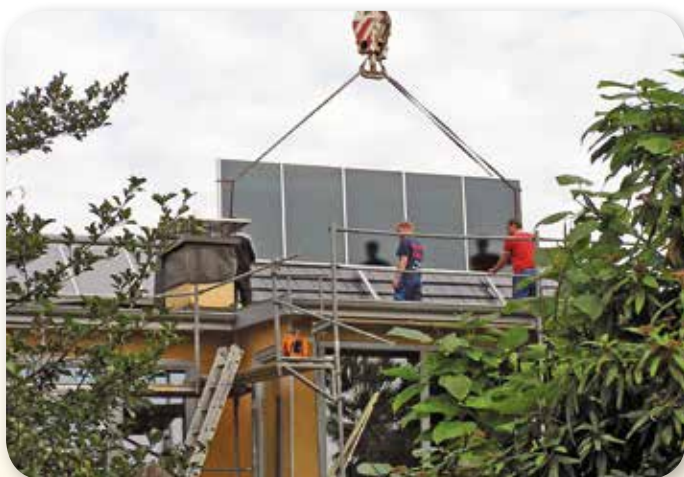
Die auf dem Dach montierte Solarfläche unterstützt die neue Gas-Brennwert-Heizung.
