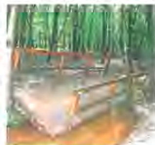
Opfer der Fluten: Die Bagno-Brücke im Grottenkamp.
