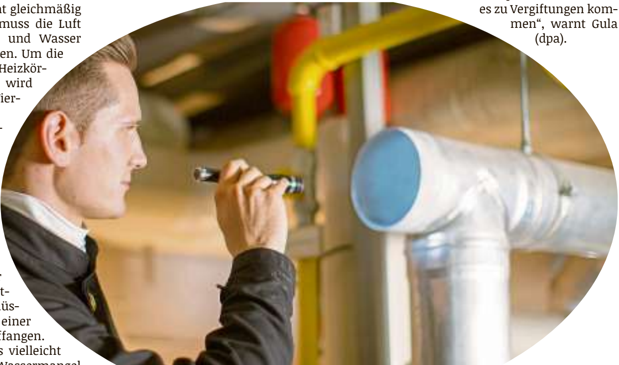
Der Heizölkessel sollte möglichst frei von Ruß sein. Der Schornsteinfeger hat das und die Kontrolle der Brennerdüse im Blick. Foto: BV des Schornsteinfegerhandwerks
