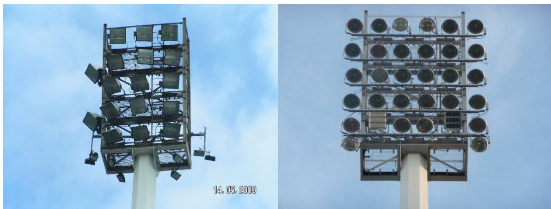
Abbildung 12: alte Flutlichtanlage / neue Flutlichtanlage
