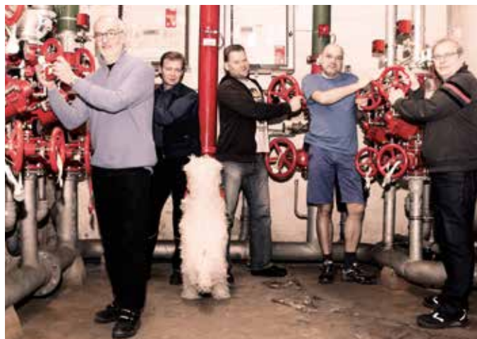
Ihre Wohlfühltemperatur in unserem Zuschauerraum regeln die Kollegen der Maschinen- und Gebäudetechnik. Nicht weniger anspruchsvoll ist ihre Sicherstellung des reibungslosen Betriebs unserer großen maschinentechnischen Anlagen.
