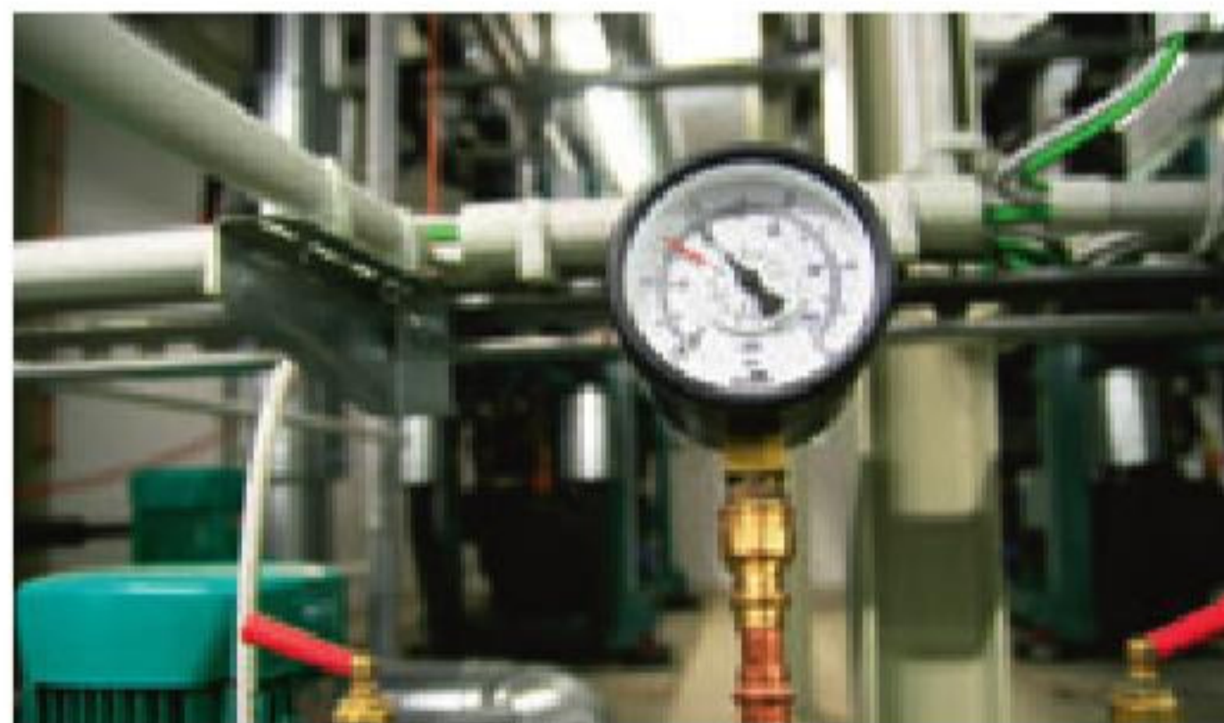
Pilotprojekt: die Geothermie-Anlage an der RUB.
