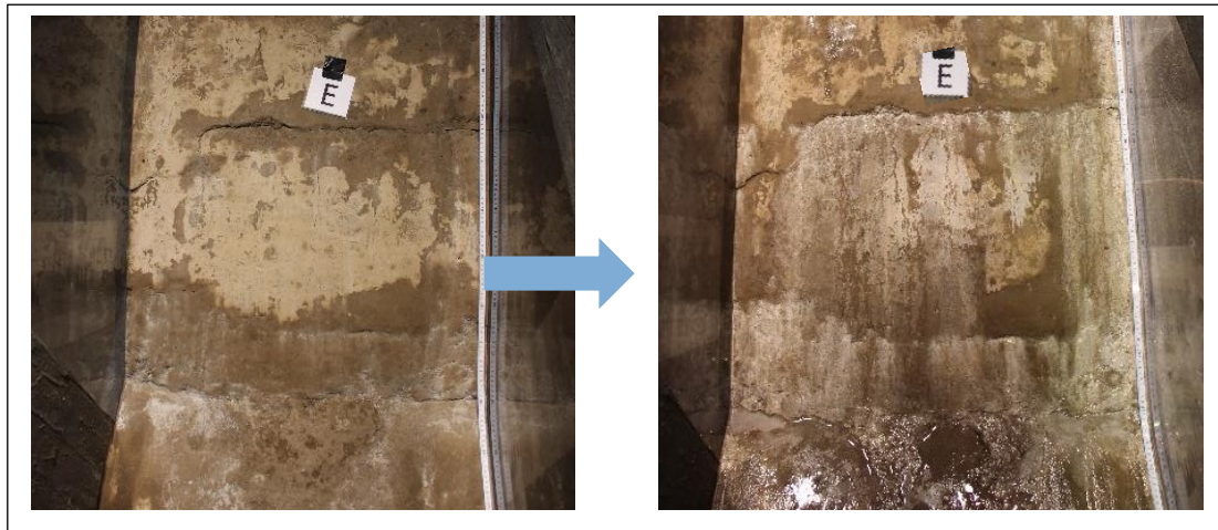
Abb. 2: Detailansicht der Böschung nach 1.1 (links) und 3.3 (rechts)
