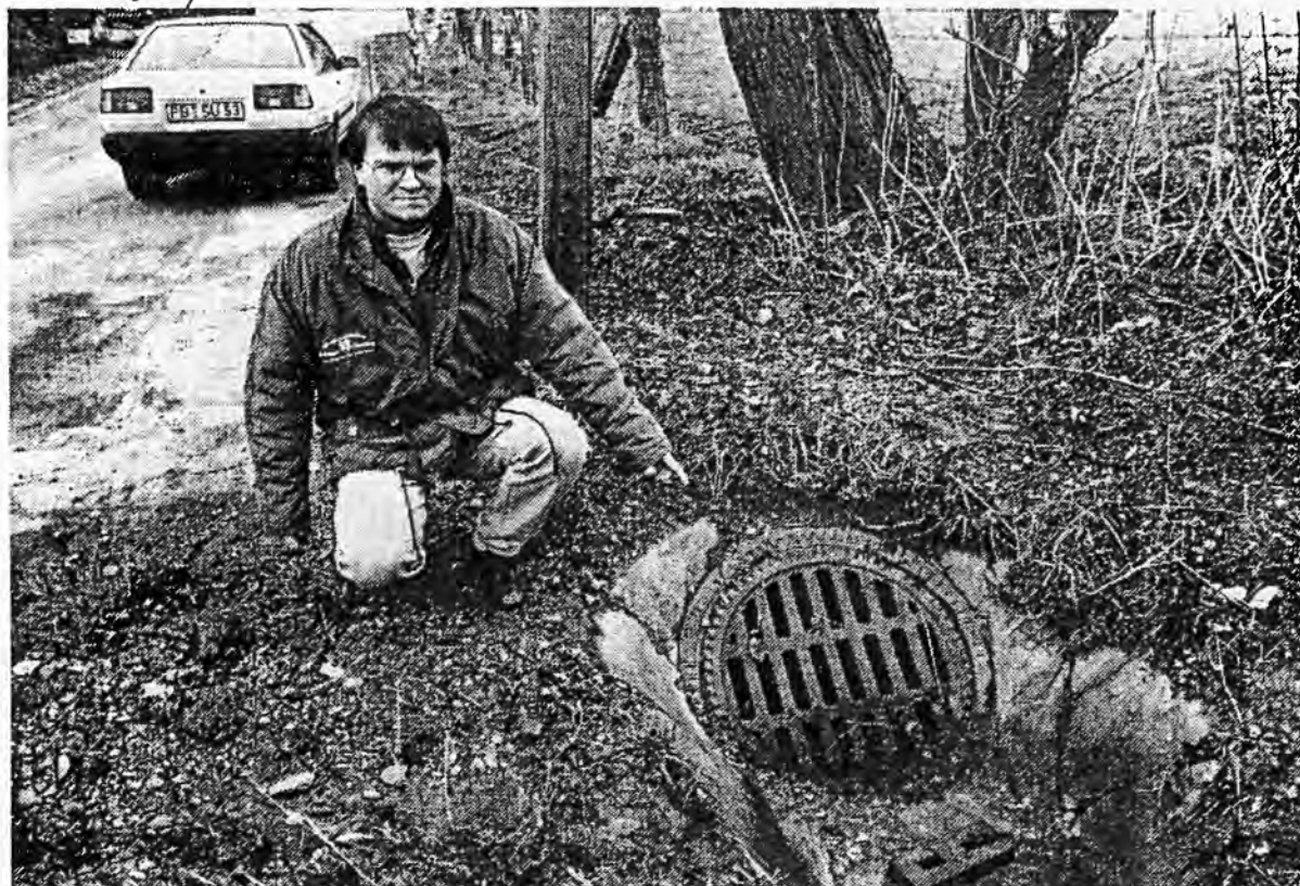
Meinolf Niggemeier am »Corpus delicti«: An dieser Stelle stauen sich nach heftigen Regengüssen die Wassermassen und überfluten den Grabenweg. Zurück bleibt ein Schlammteppich. Foto: Jürgen Splies
