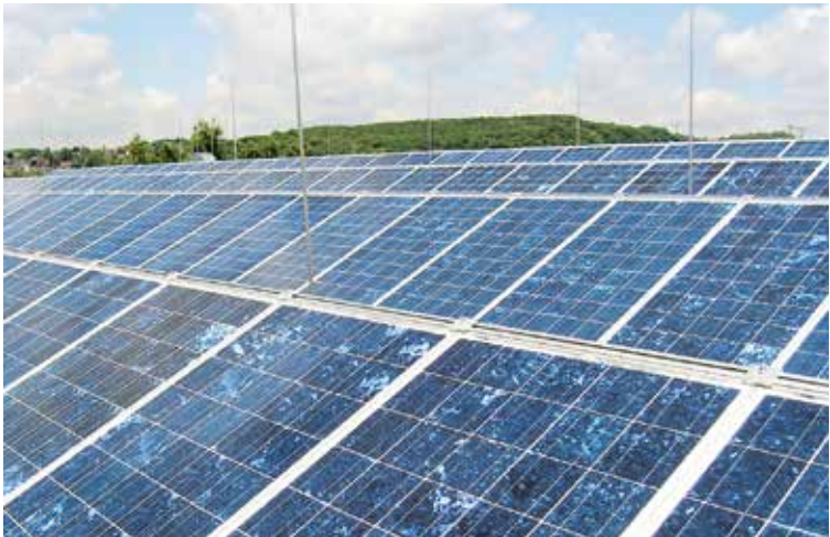
Mark-E - Photovoltaikanlage im Wasserwerk Hagen-Hengstey Foto: Enervie Südwestfalen Energie und Wasser AG
