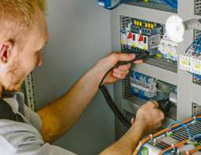
Der Fachmann prüft im Rahmen des E-Checks, ob mit der elektrischen Installation alles in Ordnung ist. Foto: ZVEH/Anna-Lena Zintel
