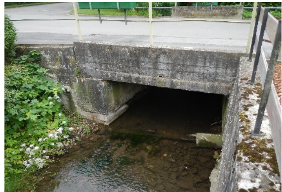
Unverbautes Ufer unterbrochen
