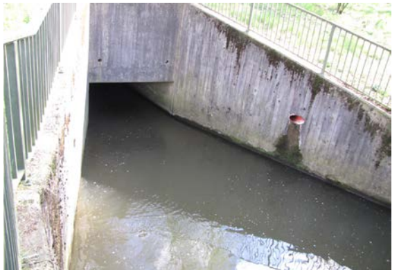
Berme nicht vorhanden
