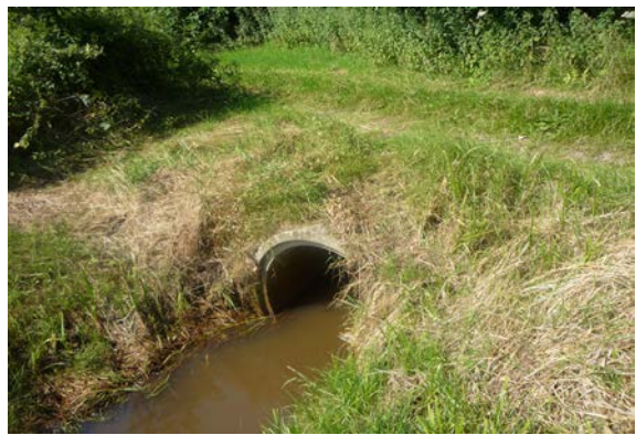
Berme nicht vorhanden
