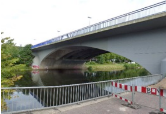
Unbefestigtes Ufer unterbrochen
