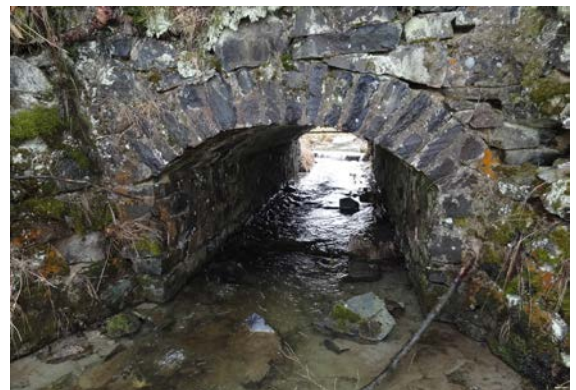
Berme nicht vorhanden
