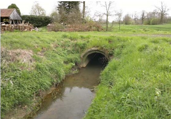
Sohle mit Sediment
