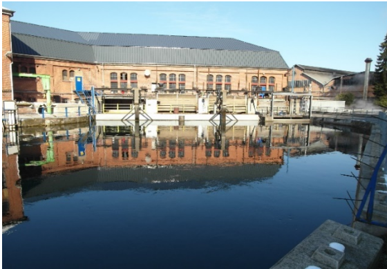
Wasserkraftanlage mit vorgeschalteter Rechenanlage
