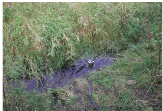
Pumpe zur Wasserentnahme, nicht als Bauwerk zu erheben
