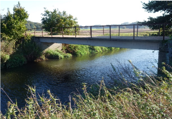
Unverbautes Ufer unterbrochen
