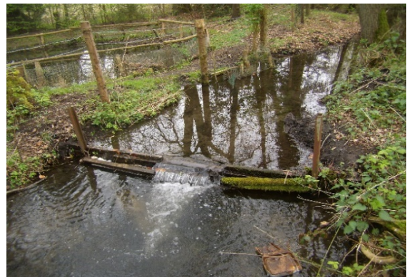
Verschlussstyp „Dammbalken“, zusätzlich Wildes Bauwerk
