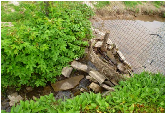
Wildes Bauwerk, Damm
