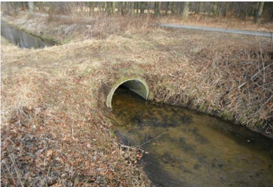
Sohle mit Sediment
