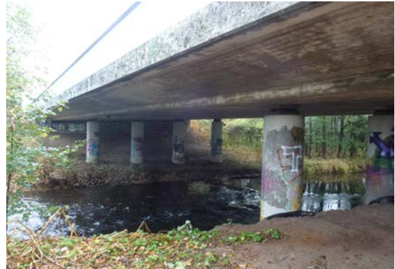
Unverbautes Ufer unterbrochen
