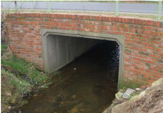
Sohle mit Sediment
