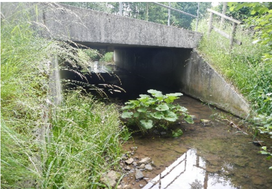
Unverbautes Ufer unterbrochen
