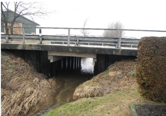
Unbefestigtes Ufer unterbrochen
