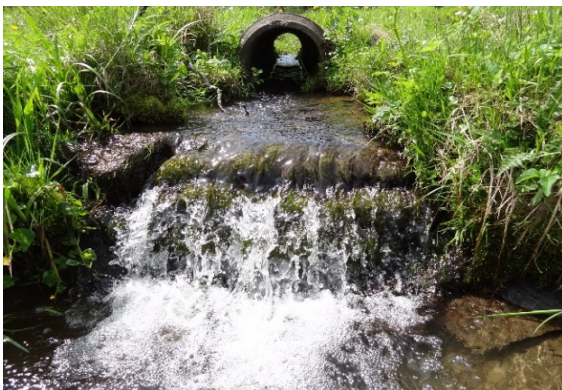
Gutes Foto: Wasserspiegeldifferenz gut zu erkennen
