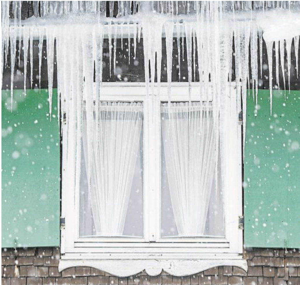
Nach Tagen klirrender Kälte wachsen Eiszapfen am Dach hinunter – was tun? Den Bereich darunter absperren, sagen Experten.
