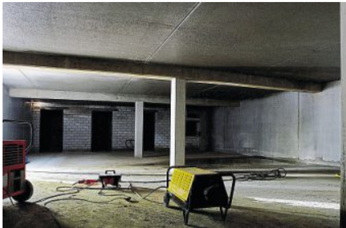
Bei Feuchtigkeit im Keller sofort reagieren: Verschiedene Methoden für unterschiedliche Ursachen.
