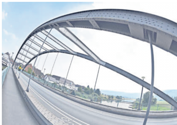
Die Weserbrücke in Beverungen ist seit einigen Jahren nur einspurig befahrbar. Ab Juli wird sie abgerissen. Foto: Harald Iding
