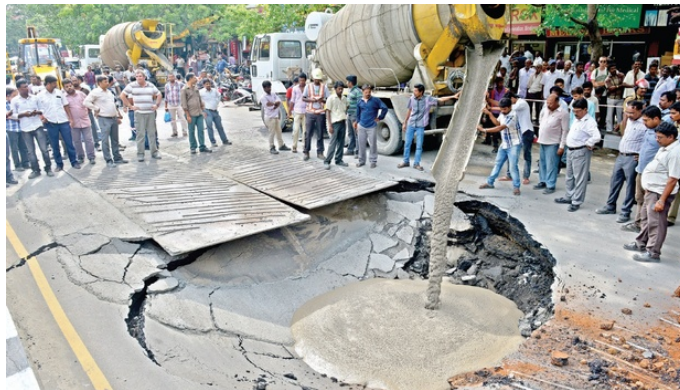
Abbildung 1.3: Absacken der Straße oberhalb des Vortriebs für den Chennai Metro Rail Tunnel, Chennai, Indien [45]
