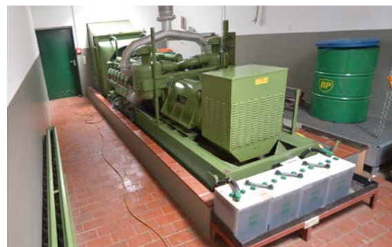
Das alte Notstromaggregat im Wasserwerk Nordrheda-Ems ist seit 1963 im Einsatz.
