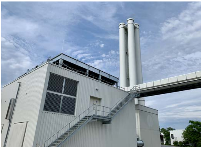
Das Blockheizkraftwerk von Mohn Media versorgt mehrere Betriebe mit Fernwärme. Foto: Mohn Media Mohndruck GmbH
