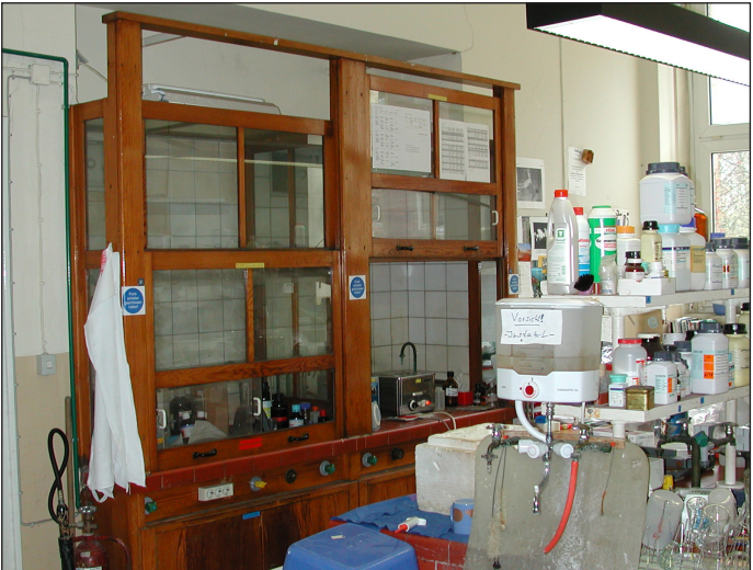
Vollkommen überalterte Abzugsanlagen erschweren die Arbeit der Biologen im Gebäude Hindenburgplatz 55. Foto: Michael Hasch
