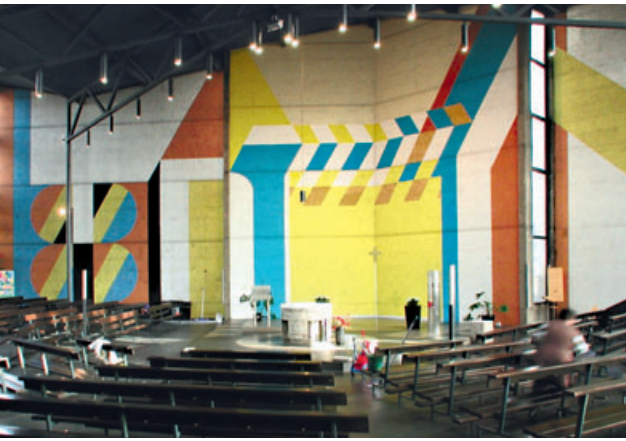
18 Altarwand mit Überfassungen. Deutlich zu erkennen sind die Verschmutzungen entlang der Schalungsfugen, 2014.
