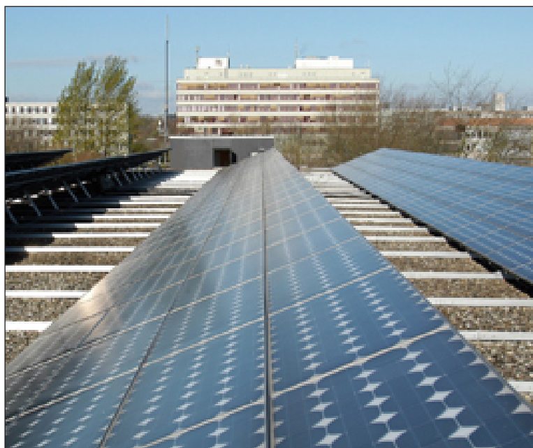
Mit Solarzellen wie hier auf dem Dach der Betriebstechnik erzeugt die Uni ihren eigenen, umweltfreundlichen Strom. Foto: Peter Grewer
