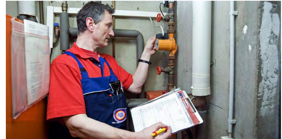
Modernisieren und sparen: Veraltete Heizungsanlagen verbrauchen zu viel Energie.
