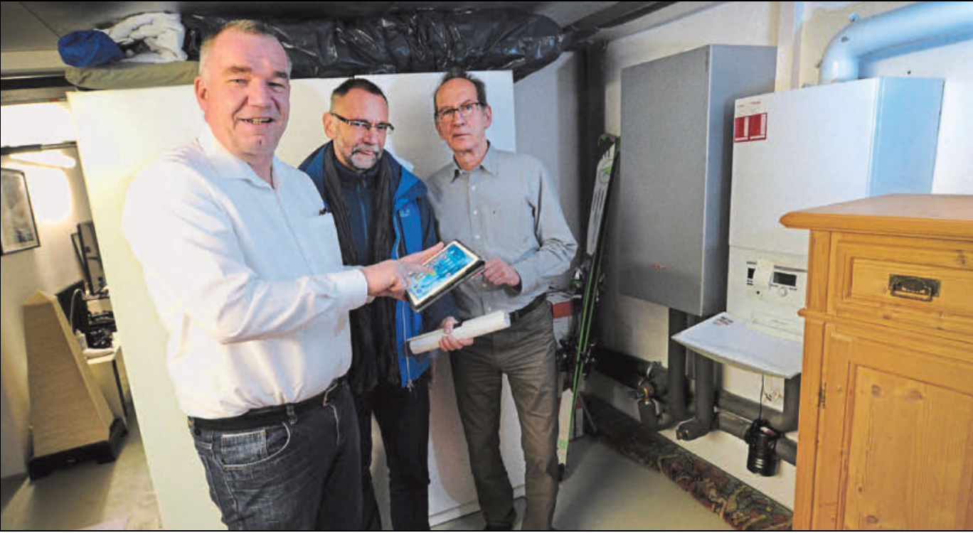
Blick in den Keller mit der modernen Heizungsanlage. Hauseigentümer Michael Seehrich (von links), Uwe Hofmeister
