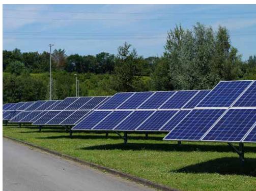
PV-Anlage am Standort Hagen
