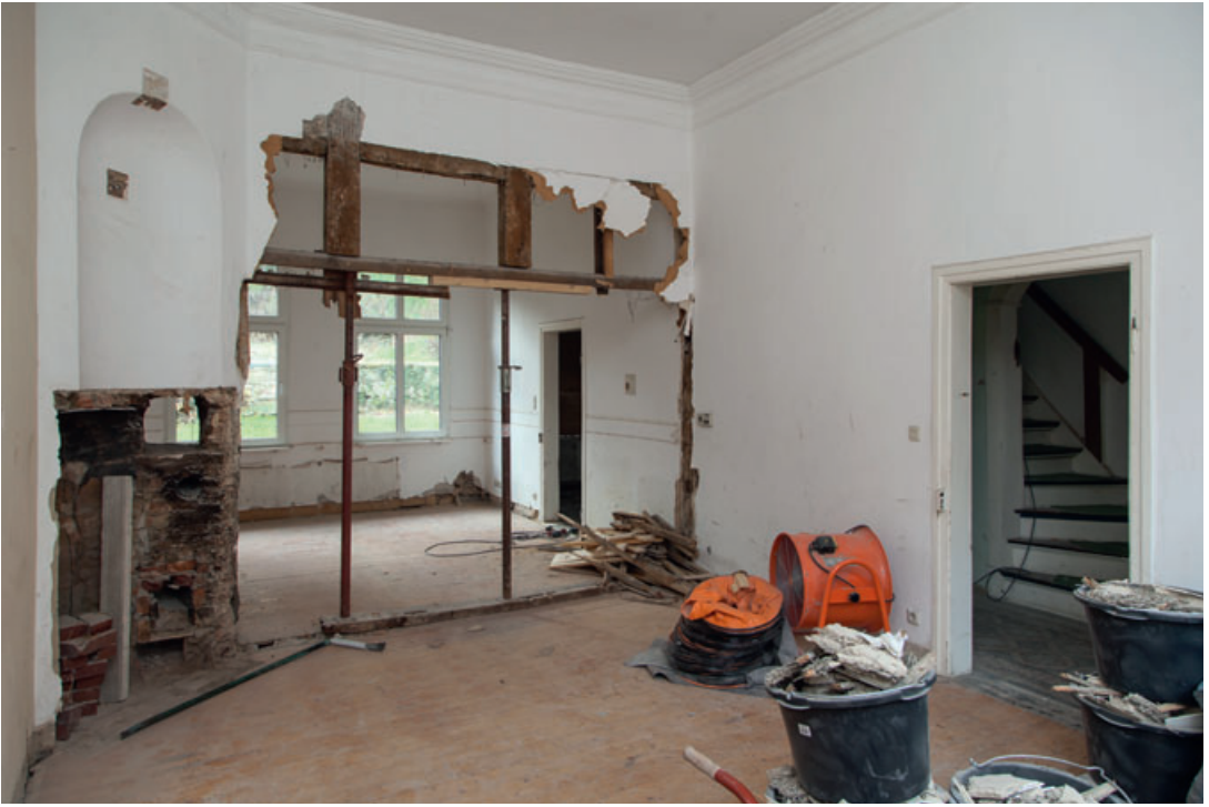
11 Nach Öffnung der Wand zwischen dem nördlichen und südlichen Wohnraum stellten sich gravierende statische Probleme heraus.
