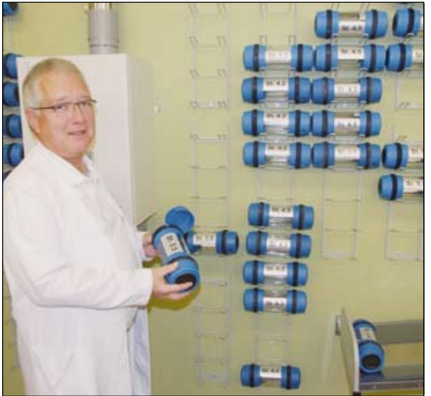
St. 4.5 oder St. 5.2 – mit dem Rohrpostsystem werden die Medikamente auf die verzweigten Wege zielsicher durchs Haus geschickt.
