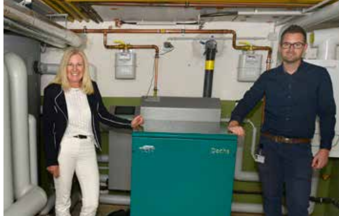
Im Keller des Mietshauses der SGW am Kösters Hof in Rüdinghausen steht ein Mini-Blockheizkraftwerk – für Wärme und autarke Stromversorgung. Claudia Pyras, Geschäftsführerin SGW, und Christian Dresel in der neuen Heizzentrale – dem Mini-Kraftwerk. Foto und Text: Barbara Zabka
