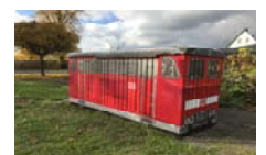
10 kV Station der Hochsauerland Netze GmbH & Co. KG in Wennemen
