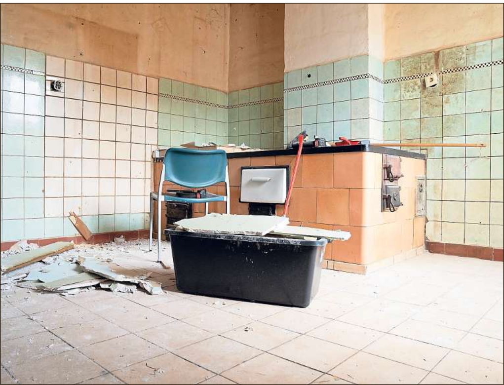
Wasserleitungen, Stromverkabelungen: Oftmals muss in älteren Gemäuern das ganze Gebäude auf den Prüfstand. Foto: Florian Schuh
