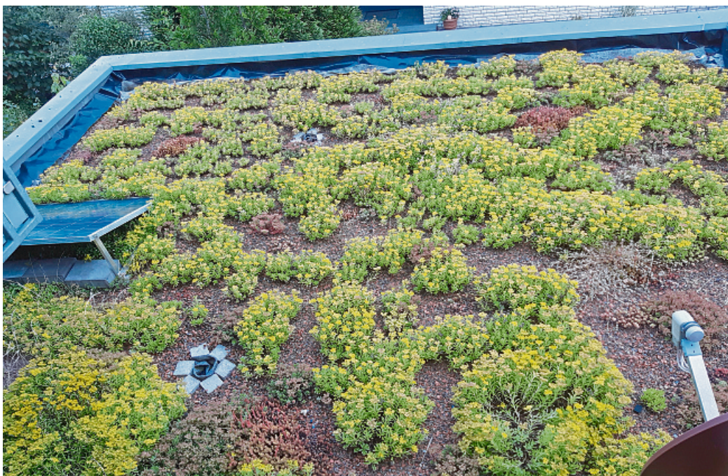
Begrünte Dächer begünstigen das Klima in Städten, kühlen im Sommer und speichern Regen zwischen. Grüne Dächer und Fassaden will die Stadt mit einem Förderprogramm bezuschussen. Foto: Angelika Knöpker
