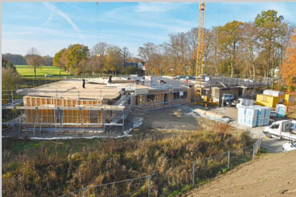
Ein Bild aus der Bauzeit: Der Rohbau steht. Mit nur 13 Monaten Bauzeit sind die Arbeiten durch heimische Firmen sehr zügig vorangegangen.
