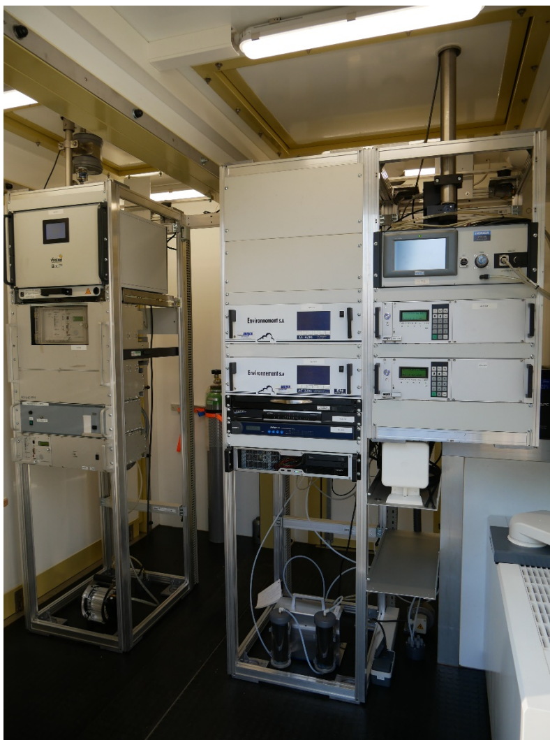
Abbildung 4: Innenansicht eines Messcontainers mit Mess- und Aufzeichnungsgeräten (Foto: LANUV)
