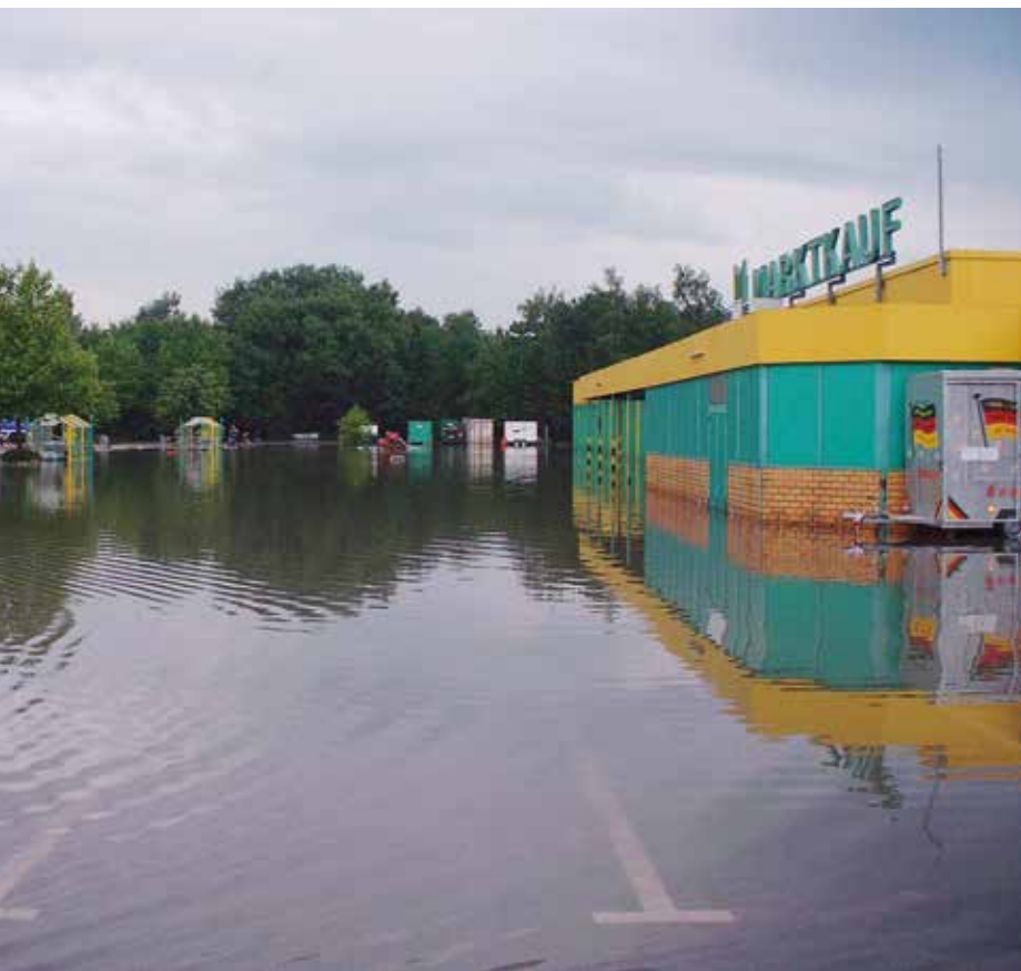
Durch den Starkregen im Jahr 2003 steht der Lemgoer Marktkauf vollständig unter Wasser
