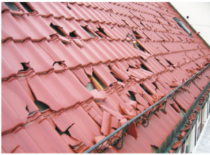
Unwetter mit Hagelschlag können erhebliche Dachschäden verursachen. Die richtige Dämmung und Abdichtung darunter können schlimmere Folgeschäden verhindern. Foto: djd/Paul Bauder
