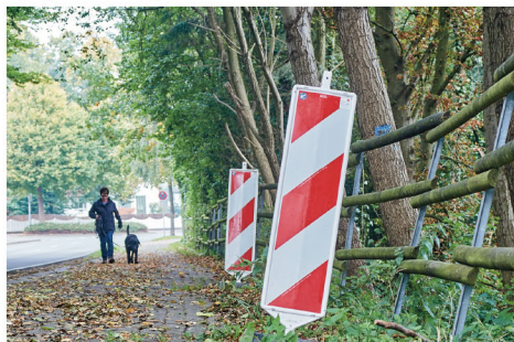
Wer mit dem Fahrrad die Absackungen des Radwegs an der Teutoburger-Wald-Straße trotz Warnbake nicht beachtet, stürzt womöglich die Böschung hinab und landet ein paar Meter tiefer im Bach. Deshalb wird der Radweg in den kommenden Wochen instandgesetzt.
