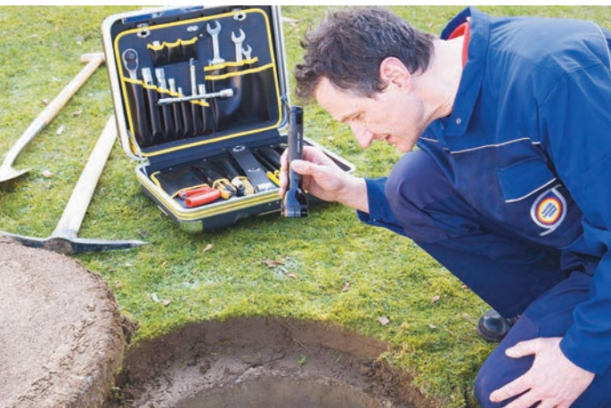
Für eine Inspektion ist es komfortabel und zeitsparend, wenn Grundstücksentwässerung oder Zisterne gut zugänglich sind. Müssen Reparaturen ausgeführt werden, zahlt sich dies erst recht aus. Foto: djd/ZVSHK
