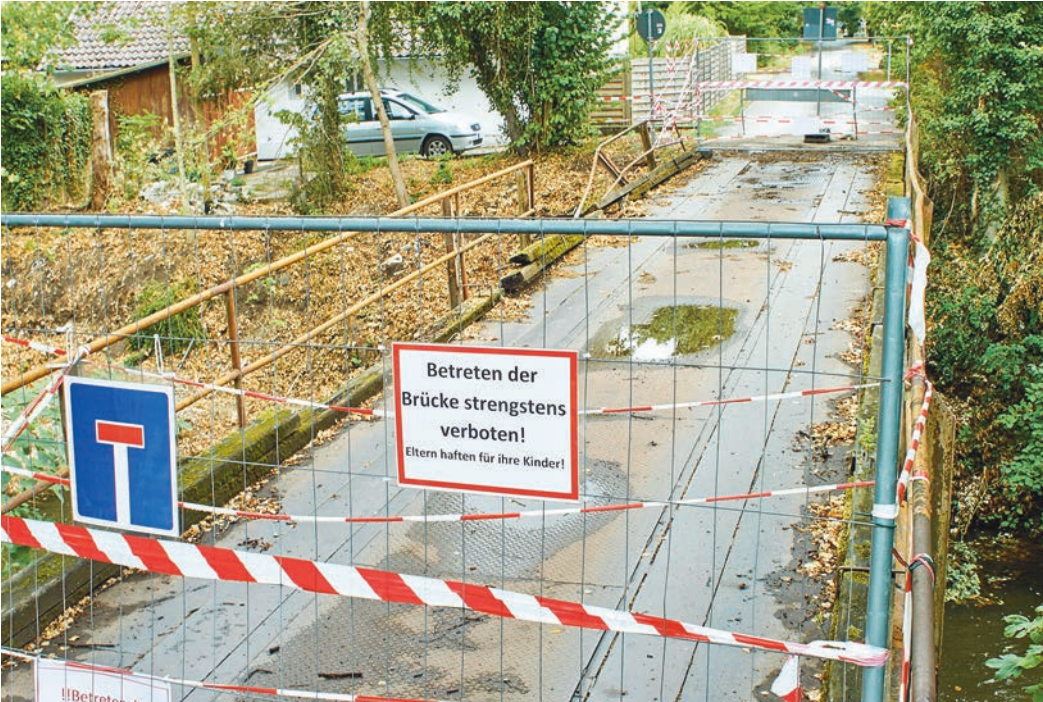
Die Brücke über die Werre wurde vor einem Monat so beschädigt, dass die Überführung gesperrt werden musste. Alle unmittelbaren Anlieger, die östlich der Brücke wohnen, müssen einen kilometerlangen Umweg in Kauf nehmen.
