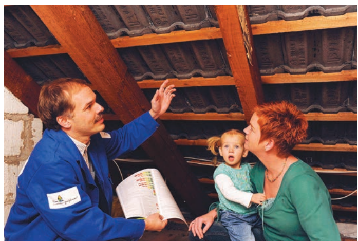
Wenn es zu Schimmelbildung durch feuchte Bauteile kommt, muss die Quelle für die Feuchtigkeit ermittelt werden - es können beispielsweise defekte Ziegel im Dach sein. Foto: djd/Bauherren-Schutzbund e.V.
