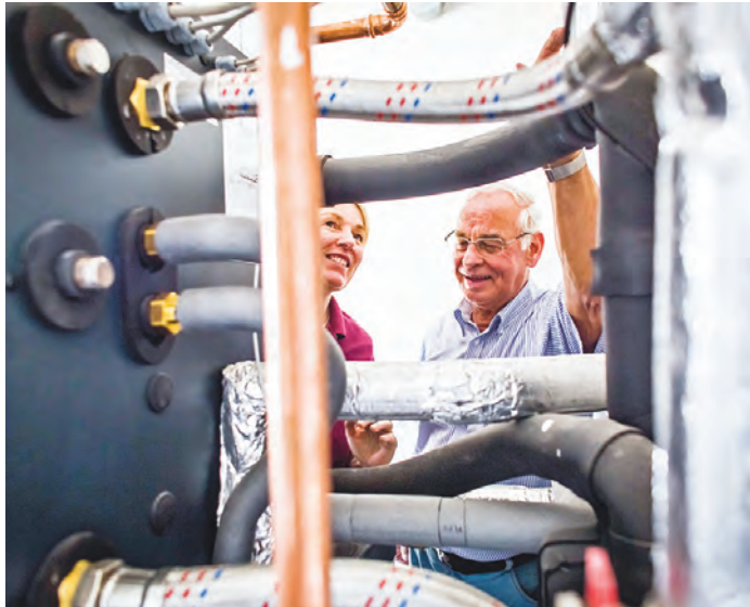
Für den Einbau neuer, energiesparender Heizanlagen in Bestandsgebäuden gibt es derzeit attraktive staatliche Förderungen. Foto: djd/Bauherren-Schutzbund
