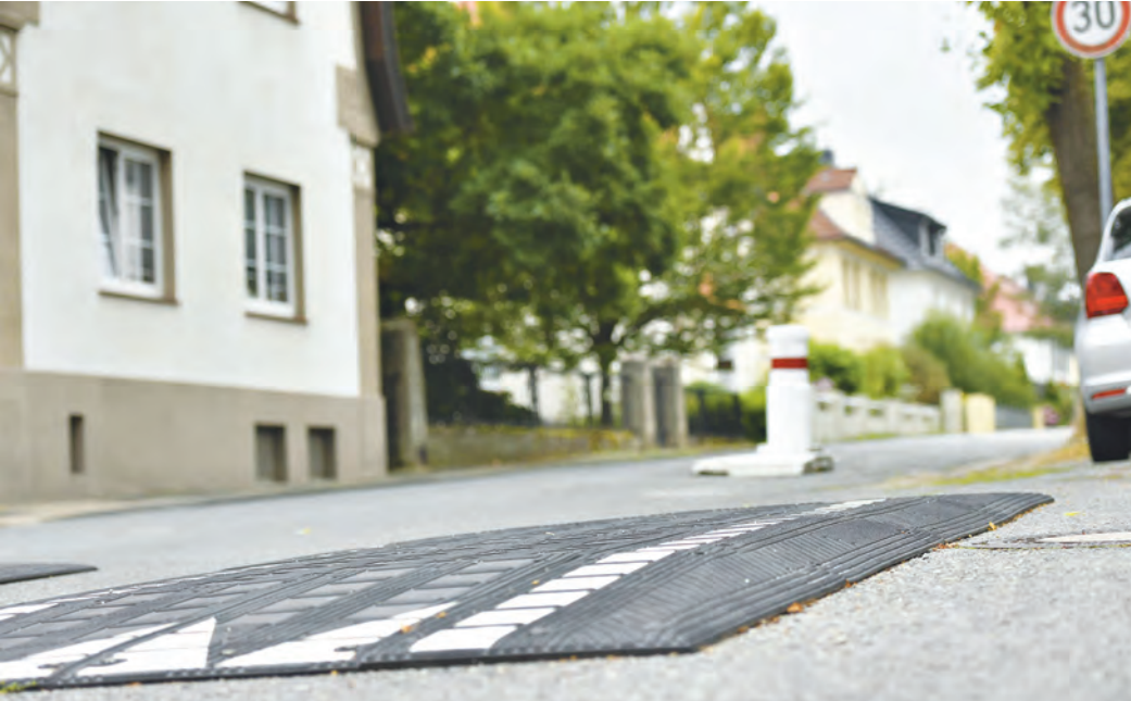
Diese Kissen werden von der Fahrbahn in der Hermannstraße entfernt.
