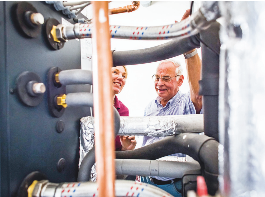
Für den Einbau neuer, energiesparender Heizanlagen in Bestandsgebäuden gibt es derzeit attraktive staatliche Förderungen. Foto: djd/Bauherren-Schutzbund
