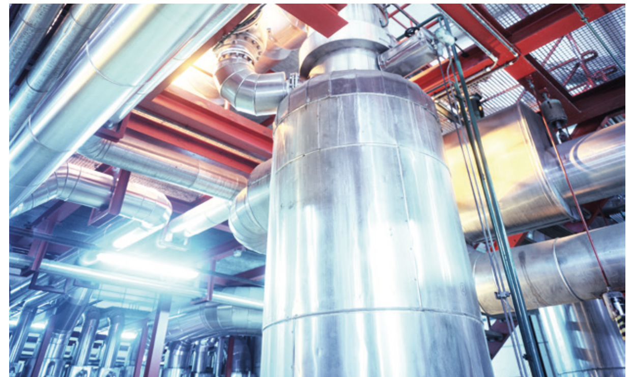
Fernwärmetauscher zur Übergabe der Fernwärme an die Stadtwerke Bielefeld
